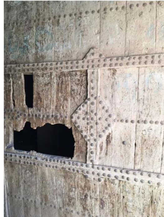
Porte d'Imin Tourga, tamarix, détail, avant restauration, 2021
