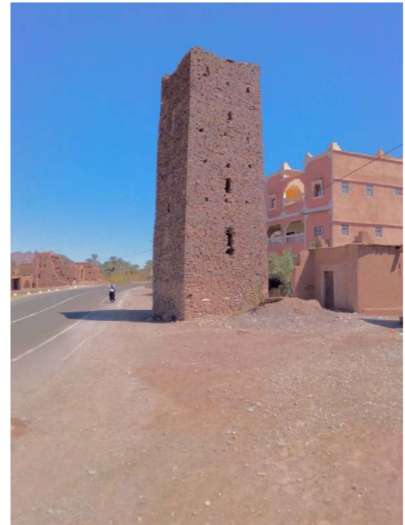
Tour de guet en pierre, Tassoukt, état 2021. Datation incertaine (1930?). Tassoukt fait face à Tamnougalt et contrôlait le gué du Draa vers Tamnougalt.
